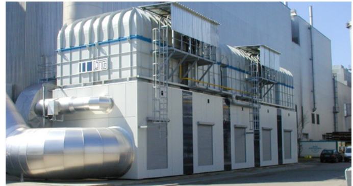
Nachverbrennungsanlage für thermisch-regenerative Abluftreinigung
