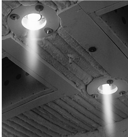
Deckenbeheizung mit Brenner BIC
